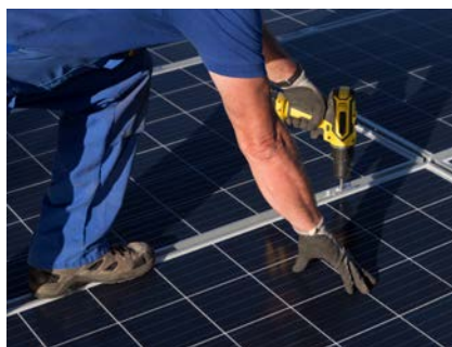
LASCO utilise elle-même la majeure partie de l'électricité produite par les 3 692 panneaux solaires installés.
