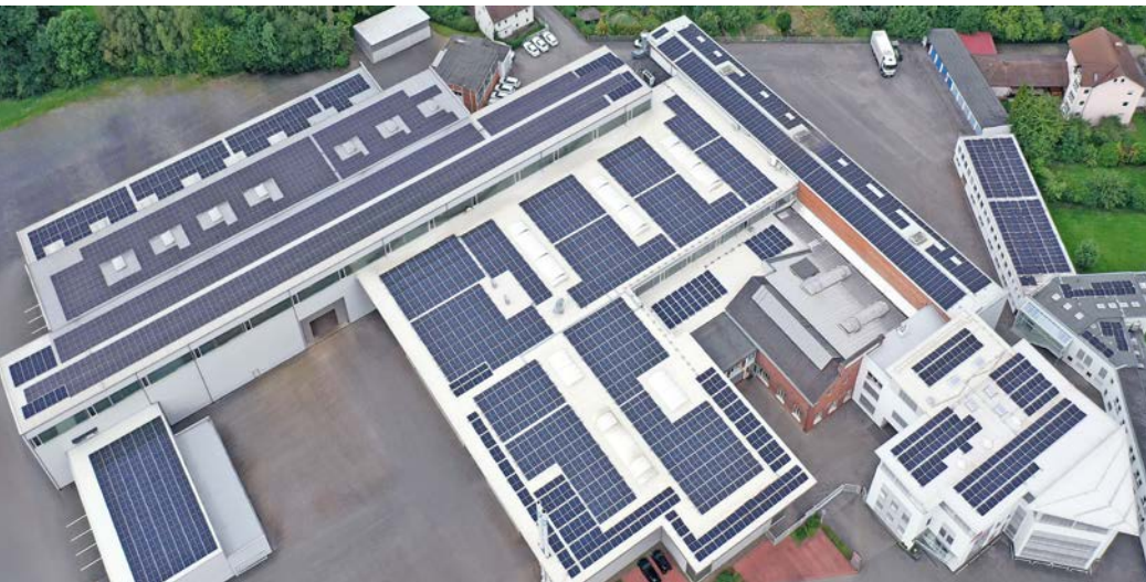
Panneaux solaires sur les bâtiments de l'entreprise : capacité augmentée de 81 %.
